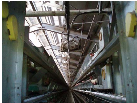
<通路に設置された順送ファン>
