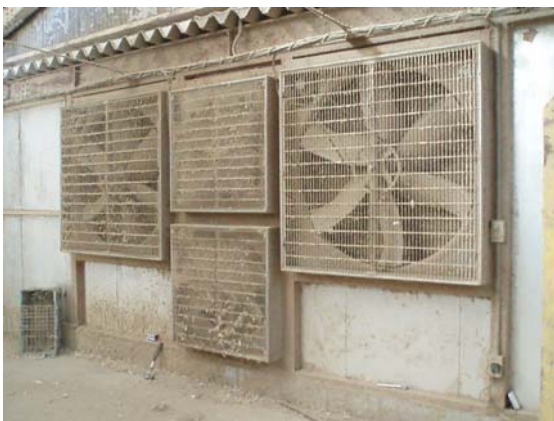
<妻面に設置された排気用ファン>
